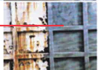
コンテナ錆落とし前と後
